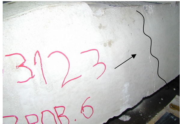
Fig. 7. Fotografía de la sección bajo carril de la traviesa 6 tras el ensayo dinámico con variación de carga escalonada en ancho internacional ( \ grieta).
