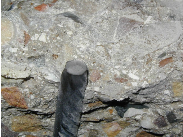
Fig. 9. Detalle de la rotura por tracción de la armadura de la traviesa 102 tras el ensayo dinámico con variación de carga escalonada y en ancho Renfe.
