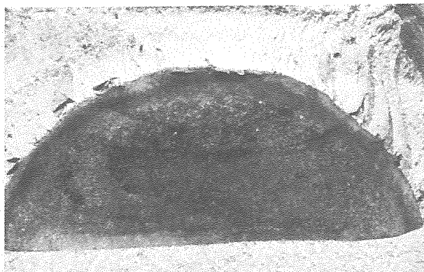
Figura 2. Fotografías de marcas dejadas por el perfil de la fisura en su avance y situación final.
