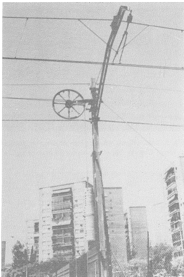
Fig 1. Vista general de un poste, que soporta una polea de regulación de tensión de la catenaria.
