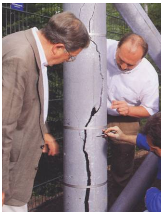
Figura 2. Ejemplo de grieta producida durante la galvanización.
