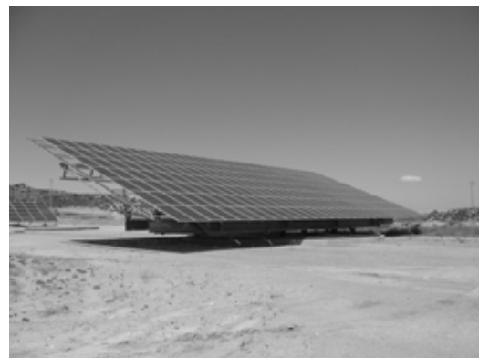
Figura 1. Fotografía general del seguidor analizado.
