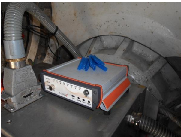
Figura 6. Equipo LEO instalado en uno de los aerogeneradores.
